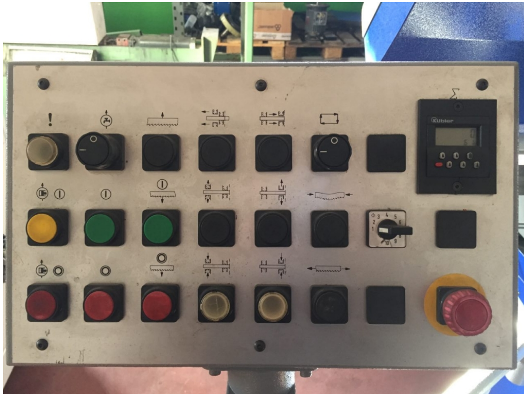
Foto pannello di controllo
