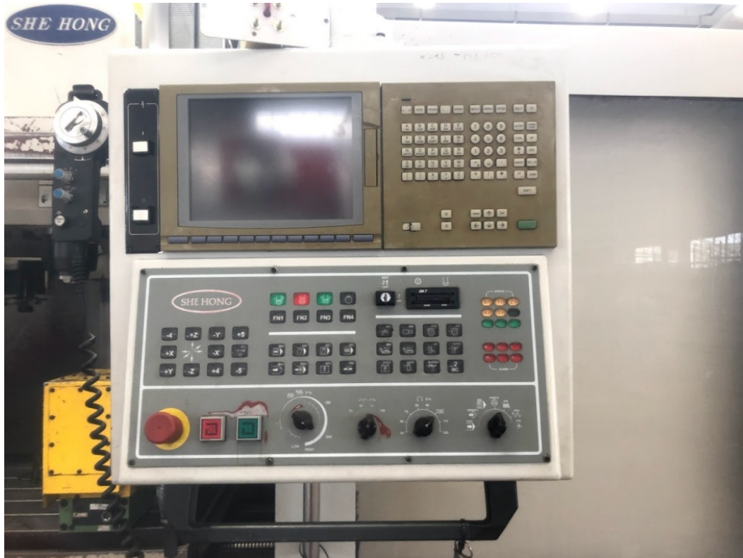
Foto pannello di controllo
